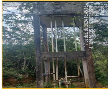
Figura 56 Fotos de Reservatórios
